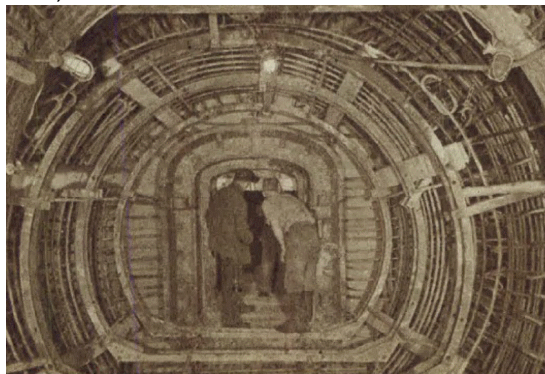
Een van de twee damdeuren, die de verbindingsgang hermetisch afsluiten en de afscheiding vormen tussen beide mijnen. Het afsluiten van de verbindingsgang met damdeuren had als doel om de luchtstroom in beide mijnen niet te verstoren.
